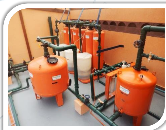
ESTAÇÃO DE TRATAMENTO EM GUARAJUBA. LITORAL NORTE/BA
